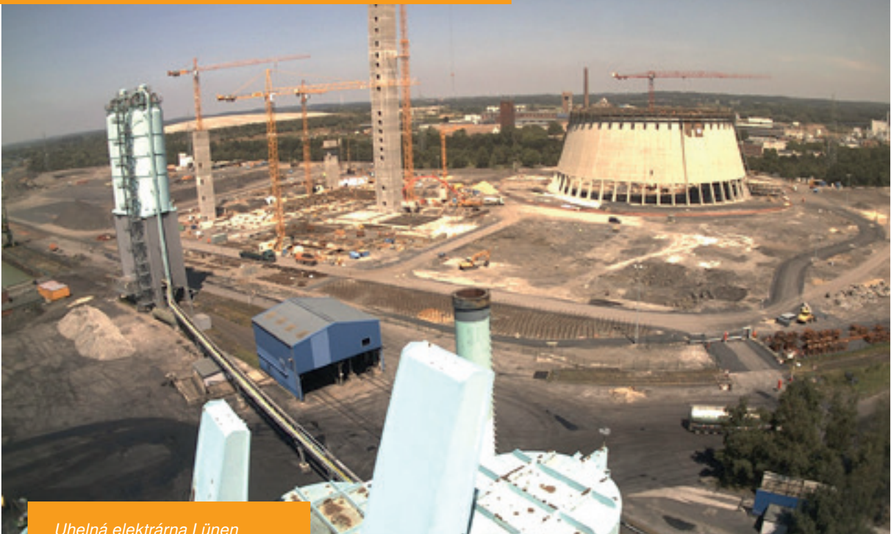
Uhelná elektrárna Lünen
