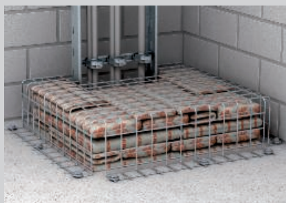
Zabezpečení proti sklouznutí nad podlahou.
