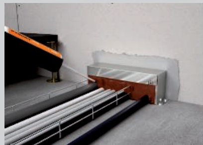
Úplné uzavření meziprostorů protipožární pěnou PYROSIT® NG
