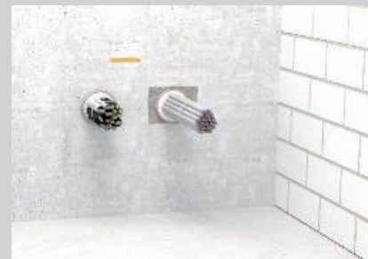
Obalové trubky plně obsazené kabelovými svazky a elektroinstalačními trubkami.
