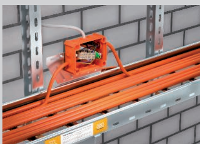
Krabice FireBox s montážní deskou typu B namontovaná na zadní straně kabelového žebříku.
