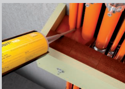
Zaplnění pěnovými bloky PYROPLUG® Block a zaplnění prostoru mezi kabely protipožární pěnou PYROSIT® NG.
