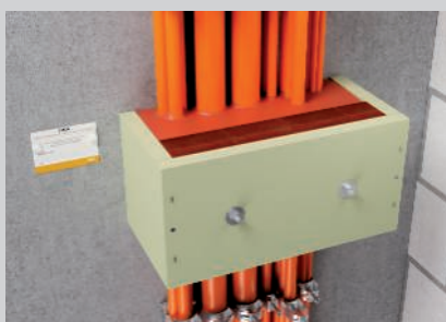
Kompletně zaplněné odlehčení tahu.
