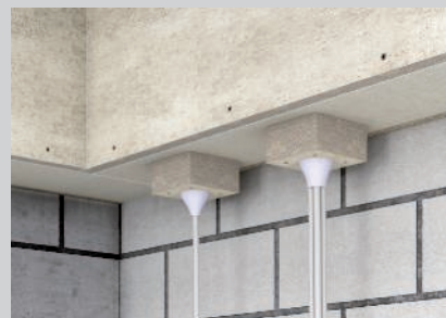
Montované protipožární potrubí s kabelovými vývody
